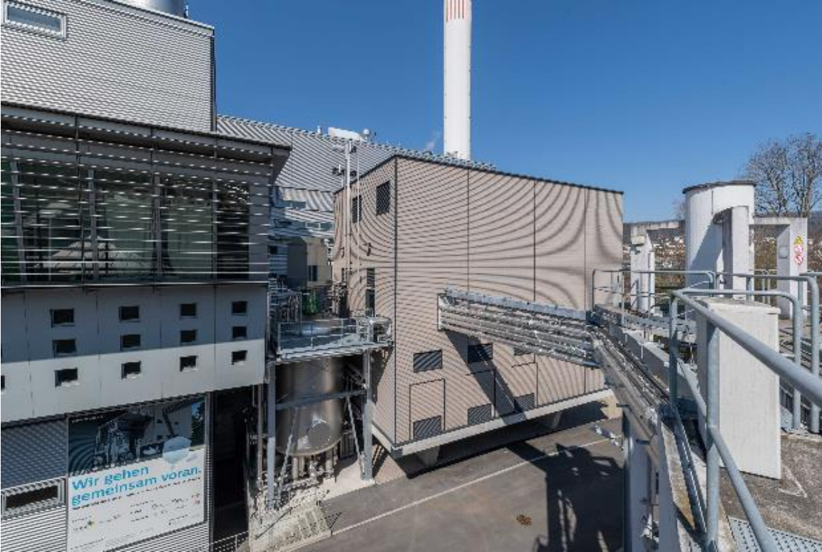
Der VSG unterstützt innovative Projekte im Gasbereich: Power-to-Gas-Anlage der Limeco in Dietikon (ZH)
