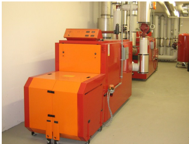
Kontrollpflichtige Feuerungsanlage (Quelle Erdölvereinigung)
